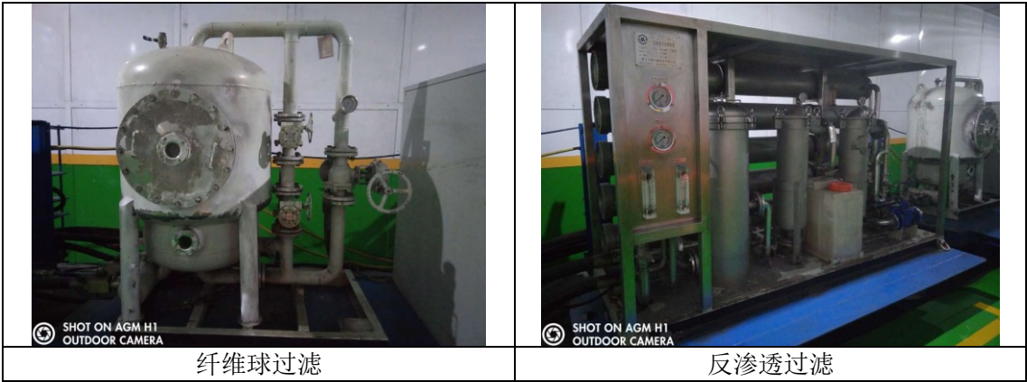
图 7.2-3 井下矿井水深度处理设施
