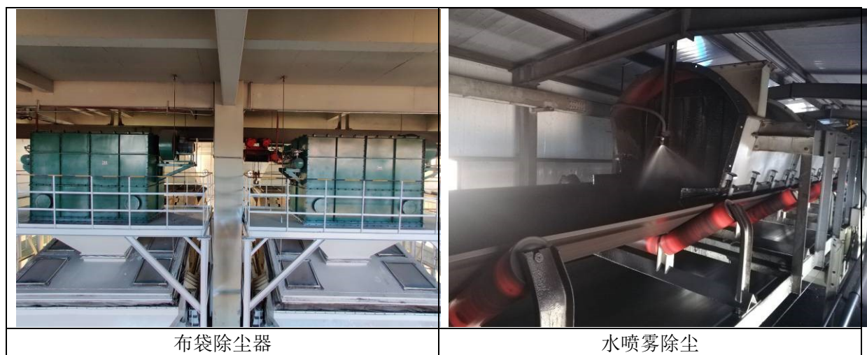
图 6.3-2 筛分破碎车间除尘设备图
