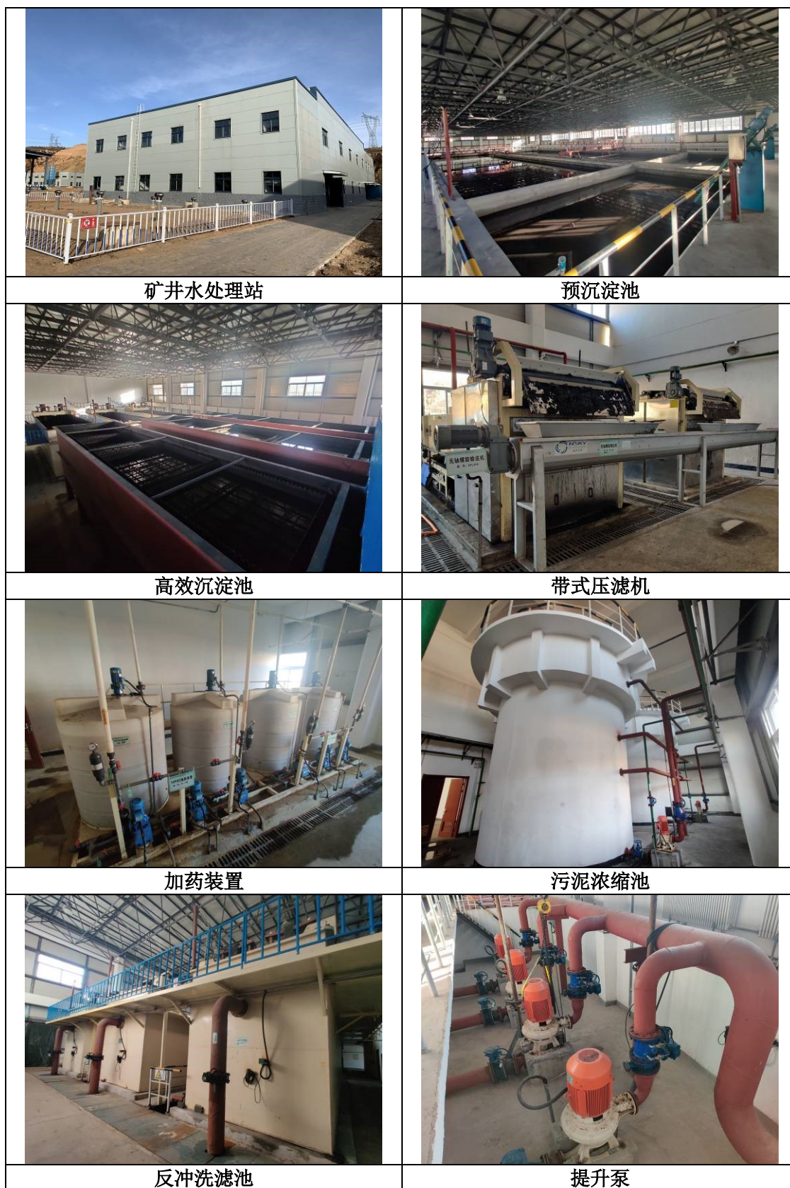
图 7.2-2 矿井水处理站常规处理工艺主要设施
